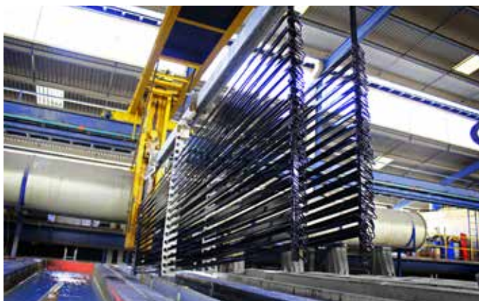
Planta de anodizado totalmente automatizada para garantizar confianza en la calidad de nuestros productos.
